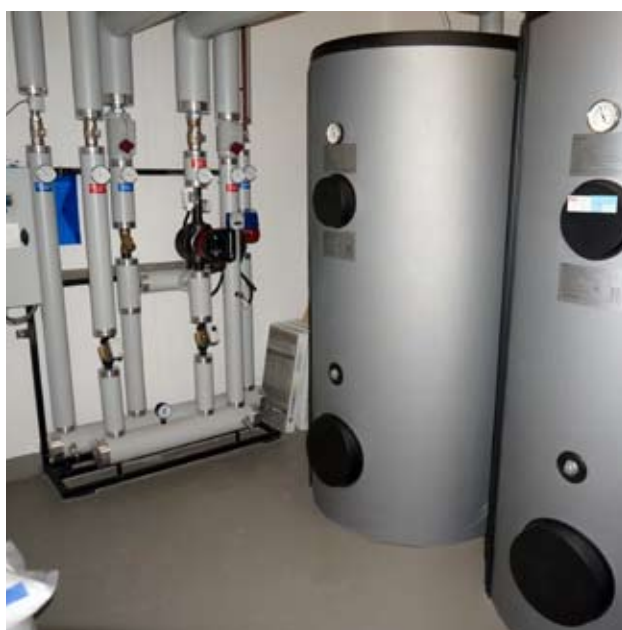
Unterstation im Wohnpark Geelig
