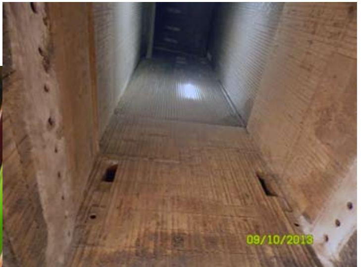
Feuerraum der Ofenlinie 3
