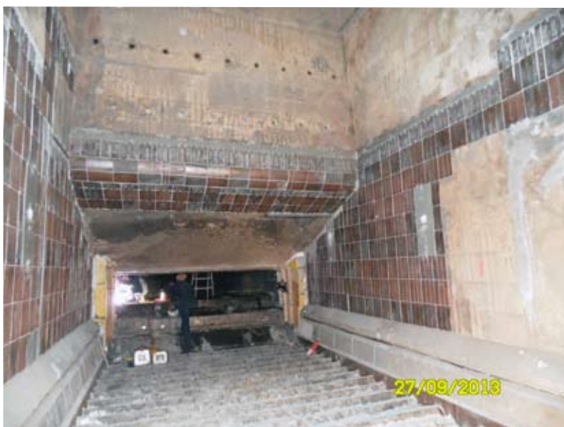
Feuerraum der Ofenlinie 4
