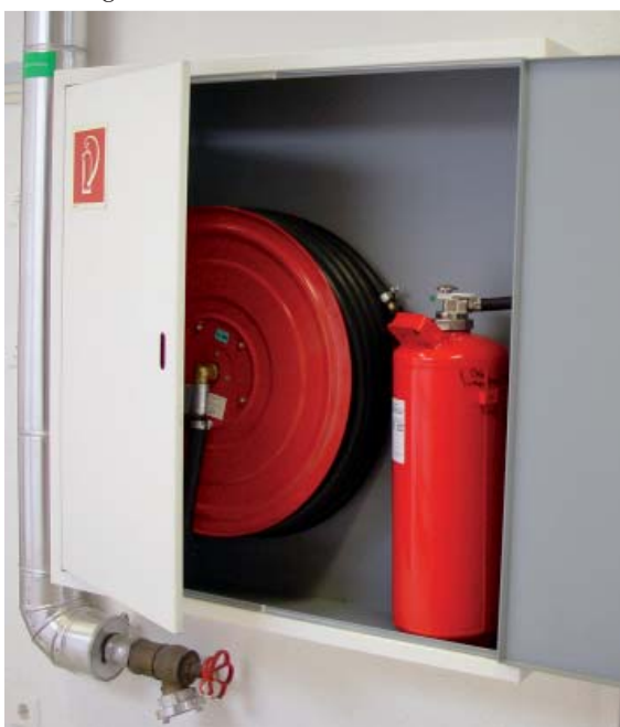
Die Feuerlöschposten werden jährlich geprüft
